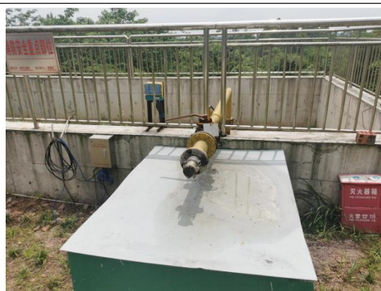
柴油罐区卸油口
